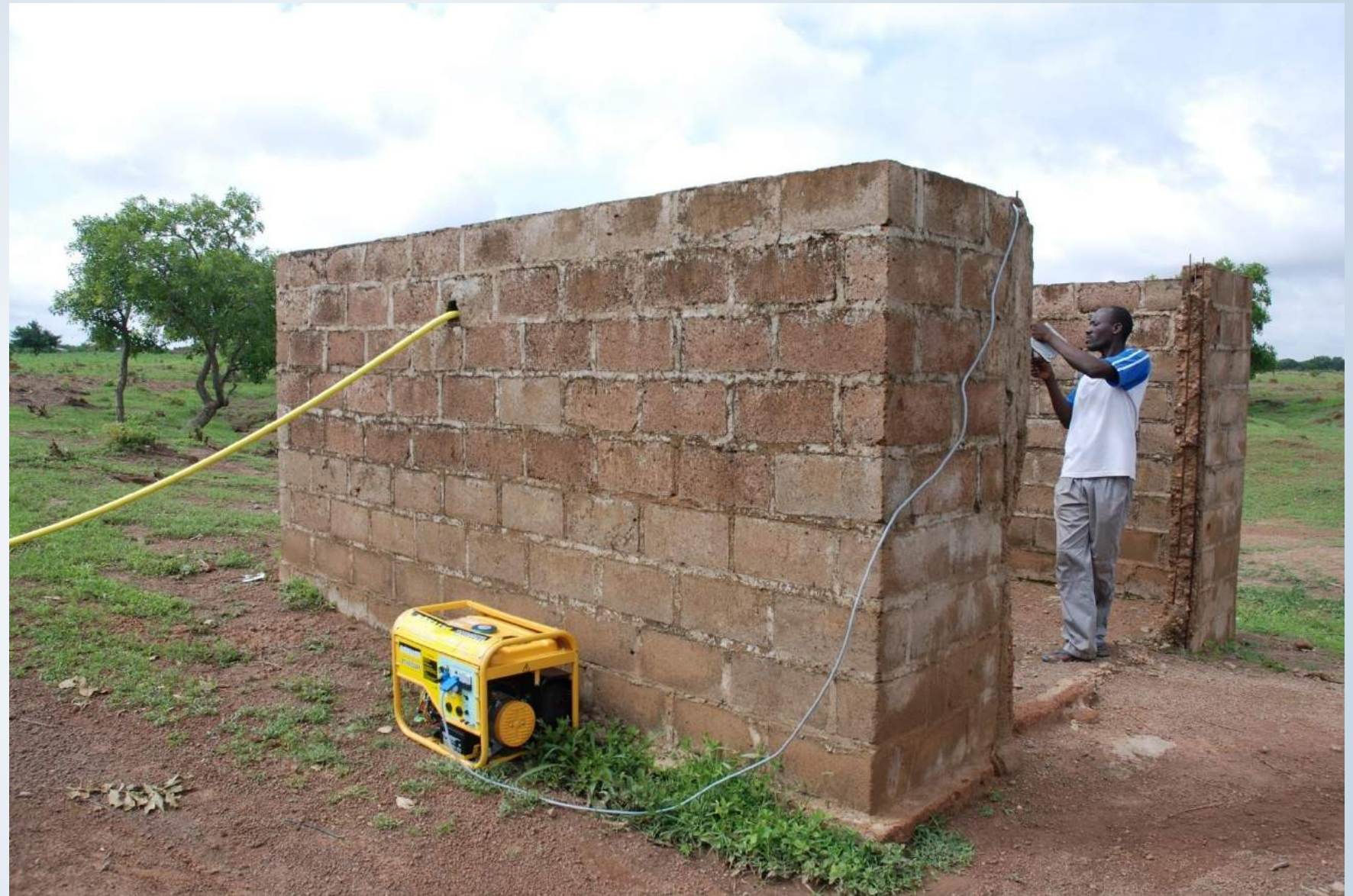
Générateur pour alimenter le moteur électrique du forage
