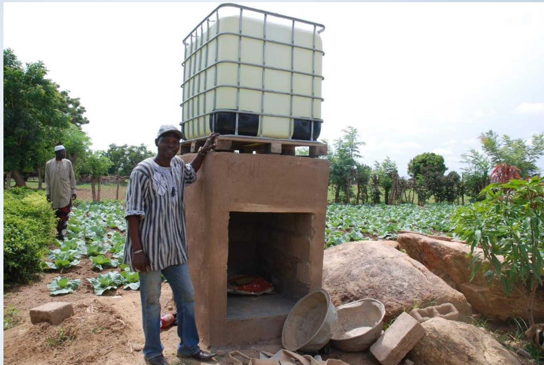
Equipement du polytank dans le troisième jardin
