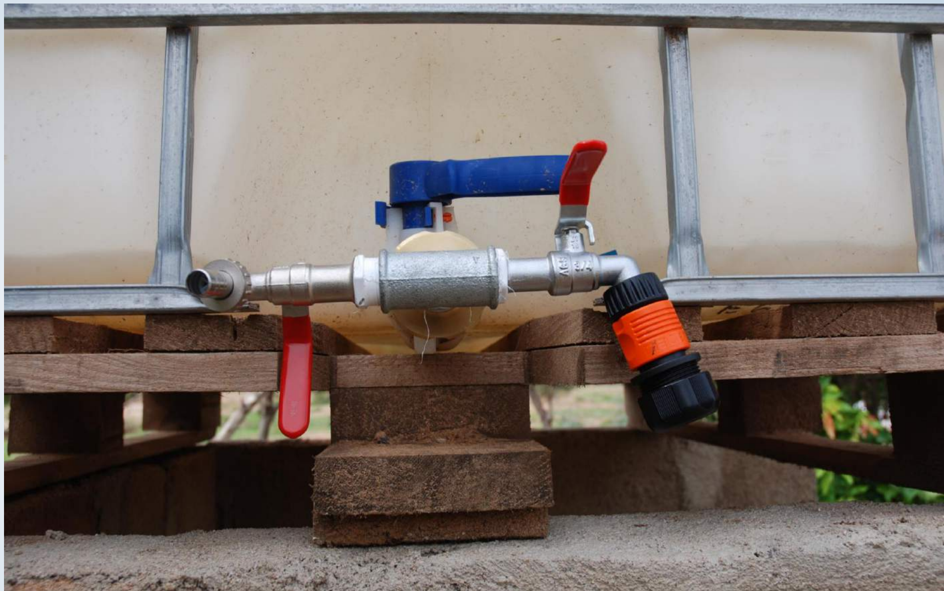
Equipement des vannes en sortie du polytank
