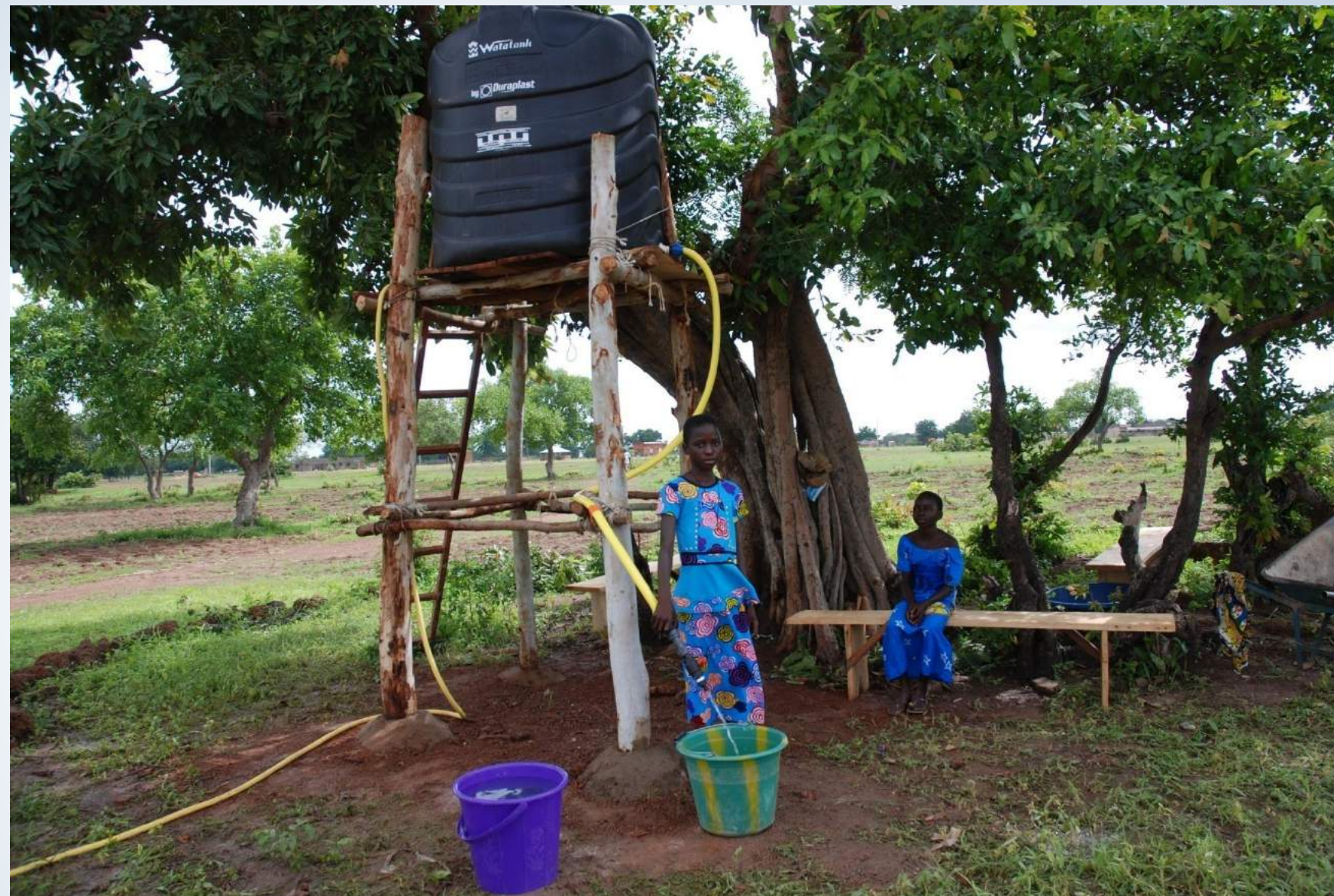
Raccordement pour le remplissage de la citerne
